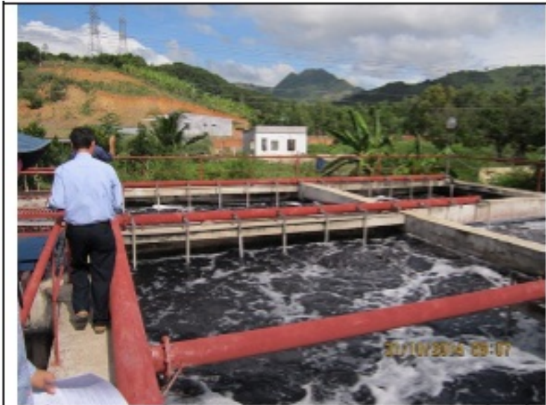
Kiểm tra hệ thống xử lý nước thải của công ty cổ phần Dệt may Nha Trang, ngày 31/10/2014 - Ảnh: CCBVMT
